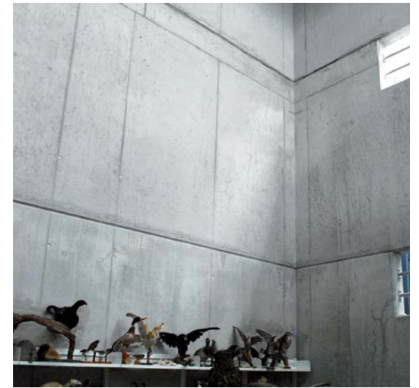
Vue de l'intérieur d'un des nouveaux noyaux de contreventement en béton édifiés au centre, également conçus pour accueillir ultérieurement des planchers en béton armé.
