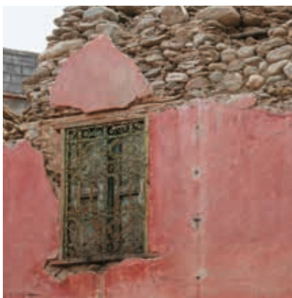
Vermörtelte Bollensteine haben im Falle eines Erdbebens eine unzureichende Verzahnung . Auch eine ungenügende Einbindung der Decken und Dächer trägt zum Versagen bei.
