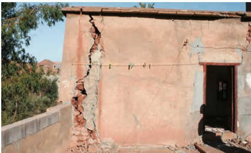
Vertikaler Riss in einem Stampflehm bau.
