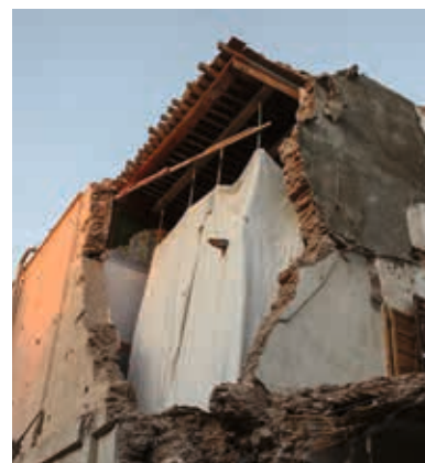
Einsturz einer Gebäudefassade aus der Ebene in der Medina von Marrakesch.
