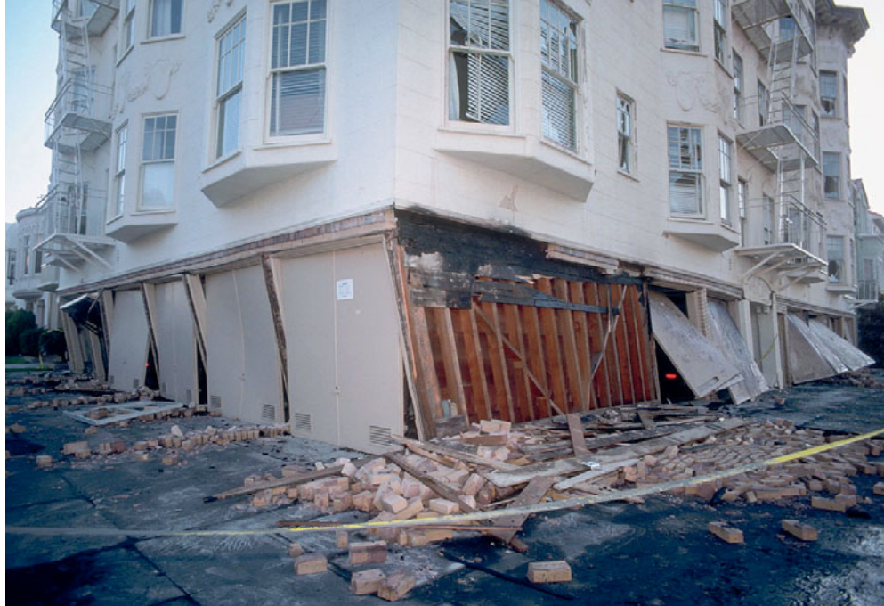
«Weiches» Geschoss (soft-storey): Keine aussteifenden Wände im Erdgeschoss. Diese Schwachstelle kommt in der Schweiz oft vor. (Foto: J.K. Nakata, United States Geological Survey).
