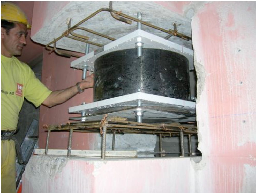
Montage eines Erdbebenlagers mit Vorspannpresse für die schwimmende Lagerung des Feuerwehrgebäudes Basel
