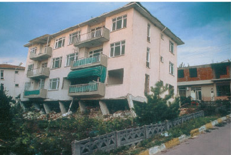
«Weiches» Geschoss (Soft-storey): Es fehlen aussteifende Wände im Erdgeschoss. Diese Schwachstelle kommt in der Schweiz oft vor.
