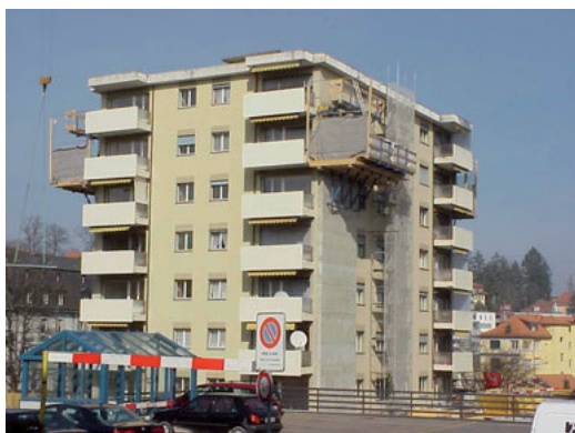
Erdbebenverstärktes Wohngebäude in Freiburg i.Ü. mit vier aussen an den Fassaden hochgezogenen schlanken Stahlbetonwänden.
