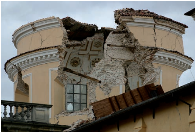
Wertvolle Kulturgüter ohne Erdbebenertüchtigung können kaum mehr reparierbare Schäden erleiden (Kirche in L'Aquila, Italien 2009)
