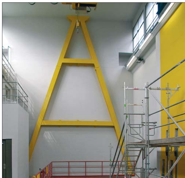
Sous-station électrique avec ses nouveaux éléments porteurs parasismiques en jaune (voir paragraphe « Sous-station électrique à Bâle »)
